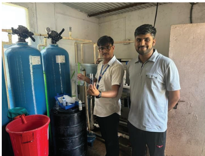
RO water testing- वेनी अस्पताल, म्याग्दी
